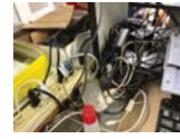
デスク周りの配線がPC中心の執務環境に対応できていない(OAフロアにする必要がある)
