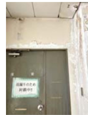
雨漏りによる劣化状態
