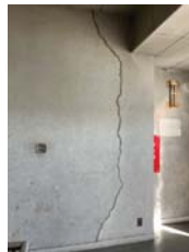
上層階部の壁の亀裂
